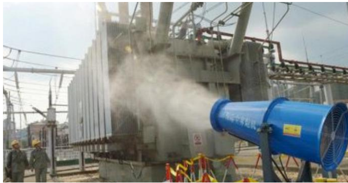
图 6 变压器油温过高故障处理办法
